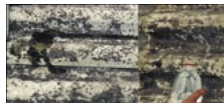
Avant : l'eau pénètre immédiatement.
